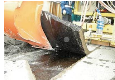
IH(電磁誘導)にて鋼床版を加熱しアスファルトを静かに剥がす
