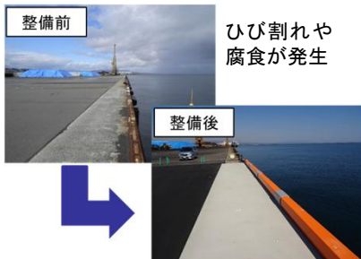
整備前 整備後 ひび割れや 腐食が発生 港湾施設の予防保全
