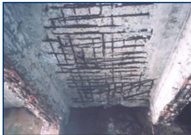
鉄筋の腐食の進行による コンクリートの剥離
