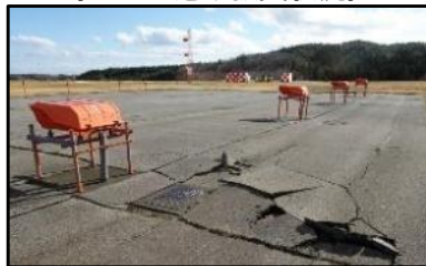
〈能登空港の被災状況〉
