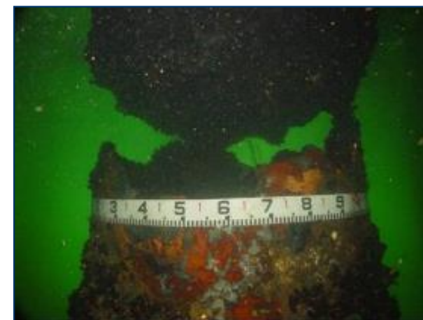
鋼管杭の腐食の進行による 杭の破断
