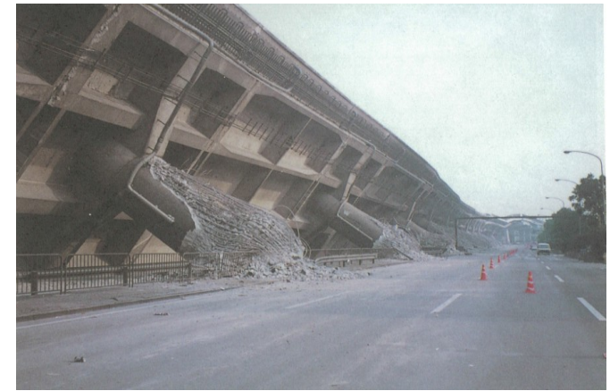
阪神高速道路3号神戸線の倒壊
