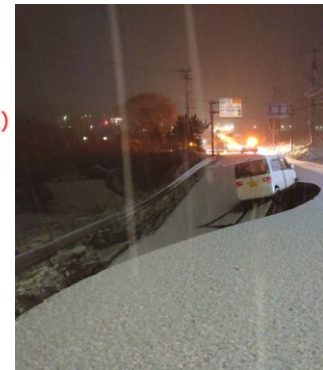
国道394号の法面崩落
