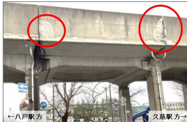
防音壁の損傷（本八戸駅～小中野駅間）
