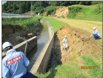
被災状況調査
