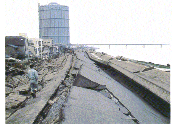
淀川堤防の崩壊 大阪市此花区西島地区
